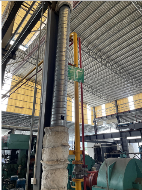
均质炉废气排气筒
