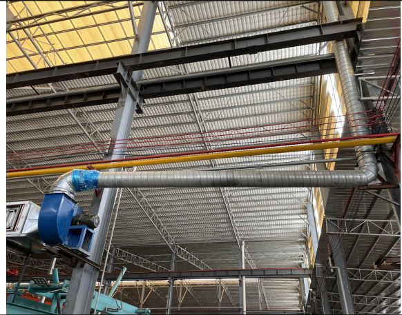
油雾废气排气筒
